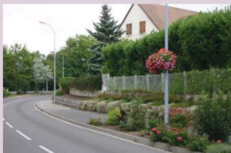
Mise en place de la 2ème partie d'alvéoles à l'entrée « est » du village
